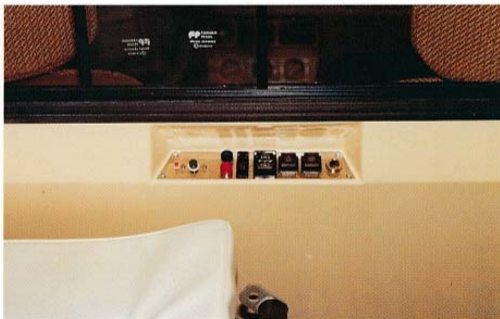
Commandes centralisées très accessibles à l'accompagnateur (plafonnier, ventilation, sonnette d'appel, chauffage, prise 150 W).
