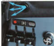
Ausgestuftes Heizungs- und Belüftungssystem
