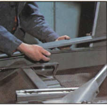
Bremsrohrleitungen, trocken und geschützt verlegt
